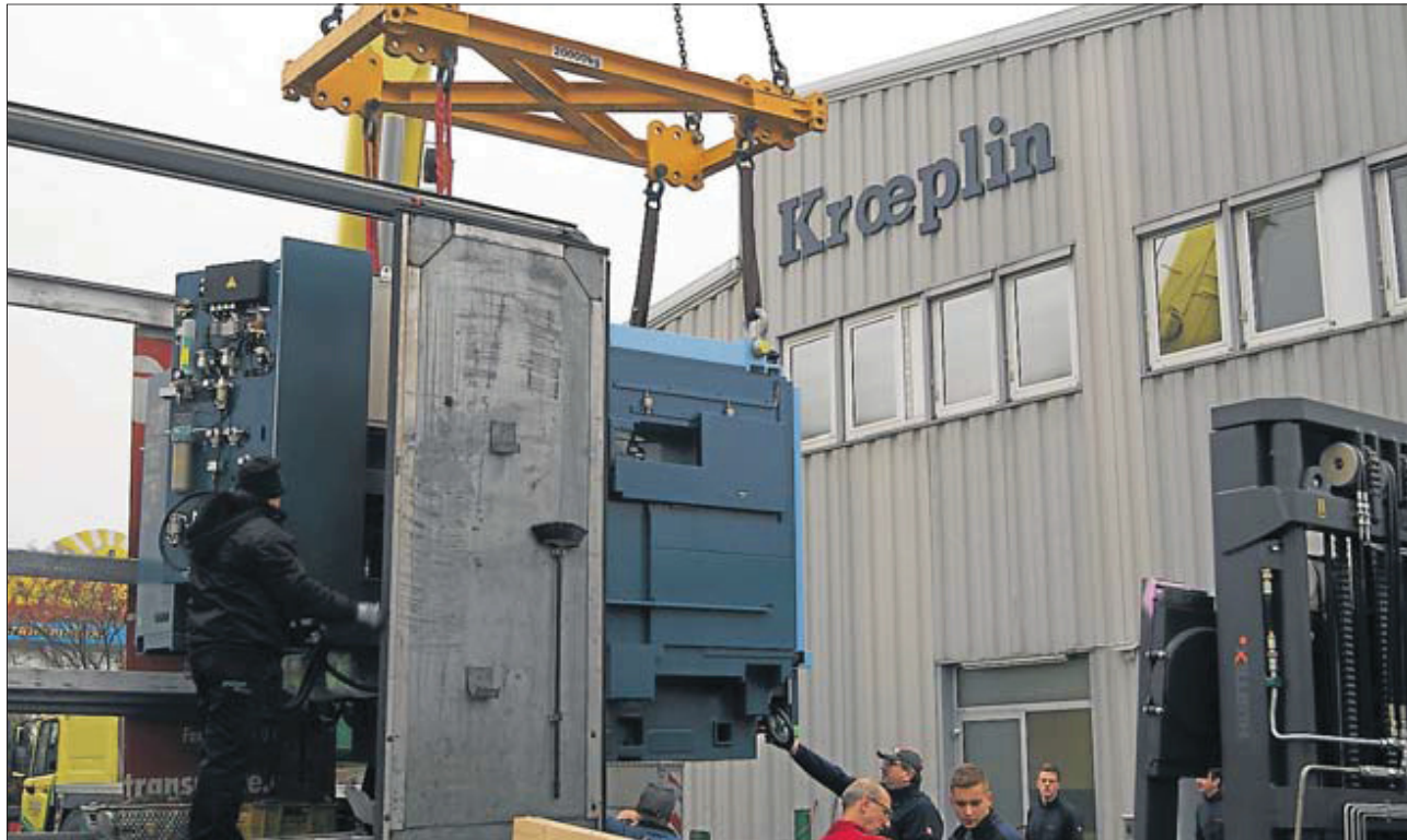
Am Haken – mehr als acht Tonnen wiegt dieses Maschinenteil. Daher muss es mit einem Kran vom Lastwagen gehievt werden. Dabei ist viel Präzision gefragt. Fotos: Christiane Hartung
